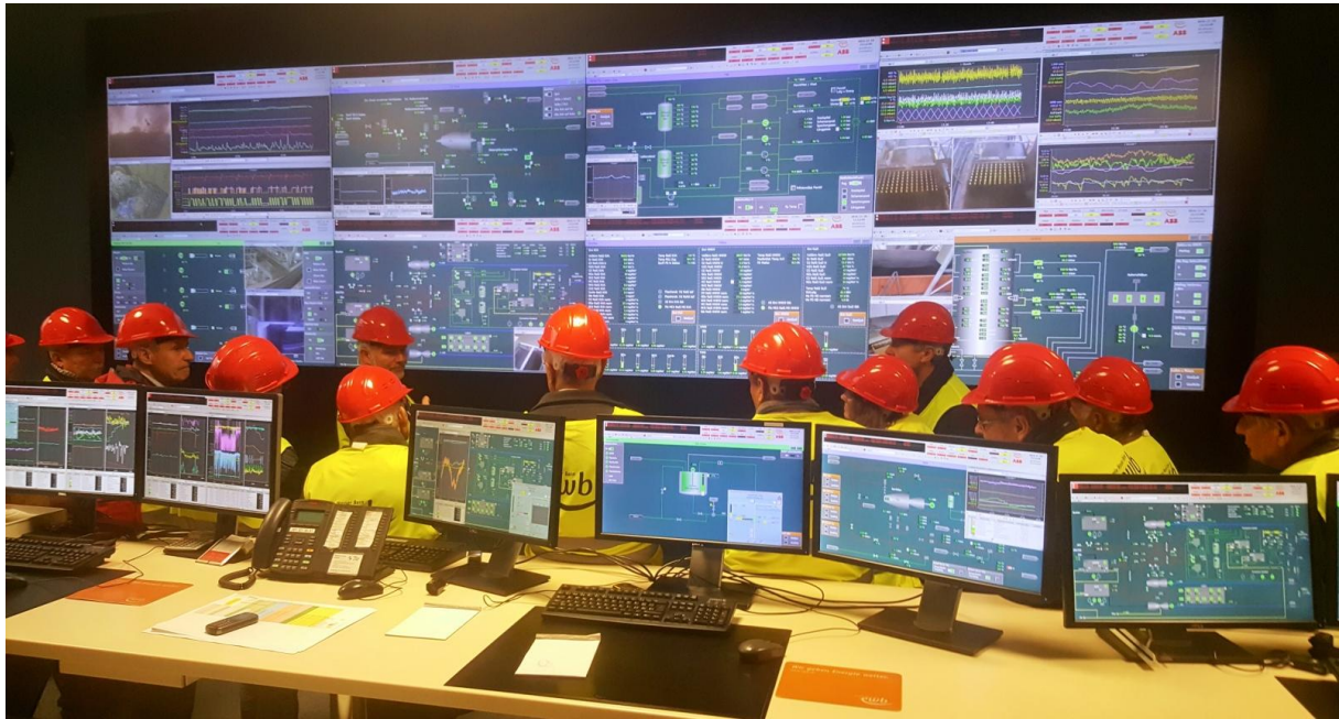
Fig. 3 Im Kontrollraum lesen wir die aktuelle Energieproduktion der Zentrale ab (Foto: U. Seemann) Fig. 3 In the control room we read off the current energy generation of the plant. (Photo: U. Seemann)
